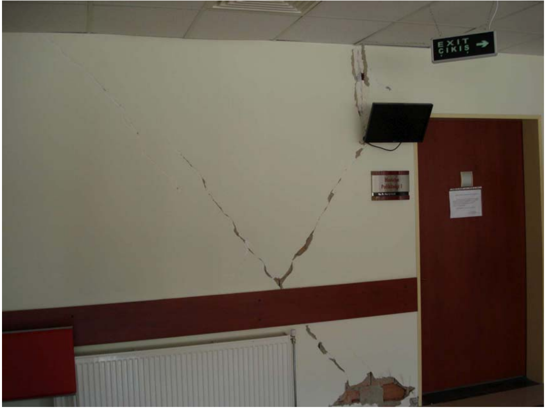
Şekil 66: Hastane kompleksinin birkaç ay önce açılan binası - dolgu duvarı çatlağı, ancak bina hizmet verebilir düzeyde
