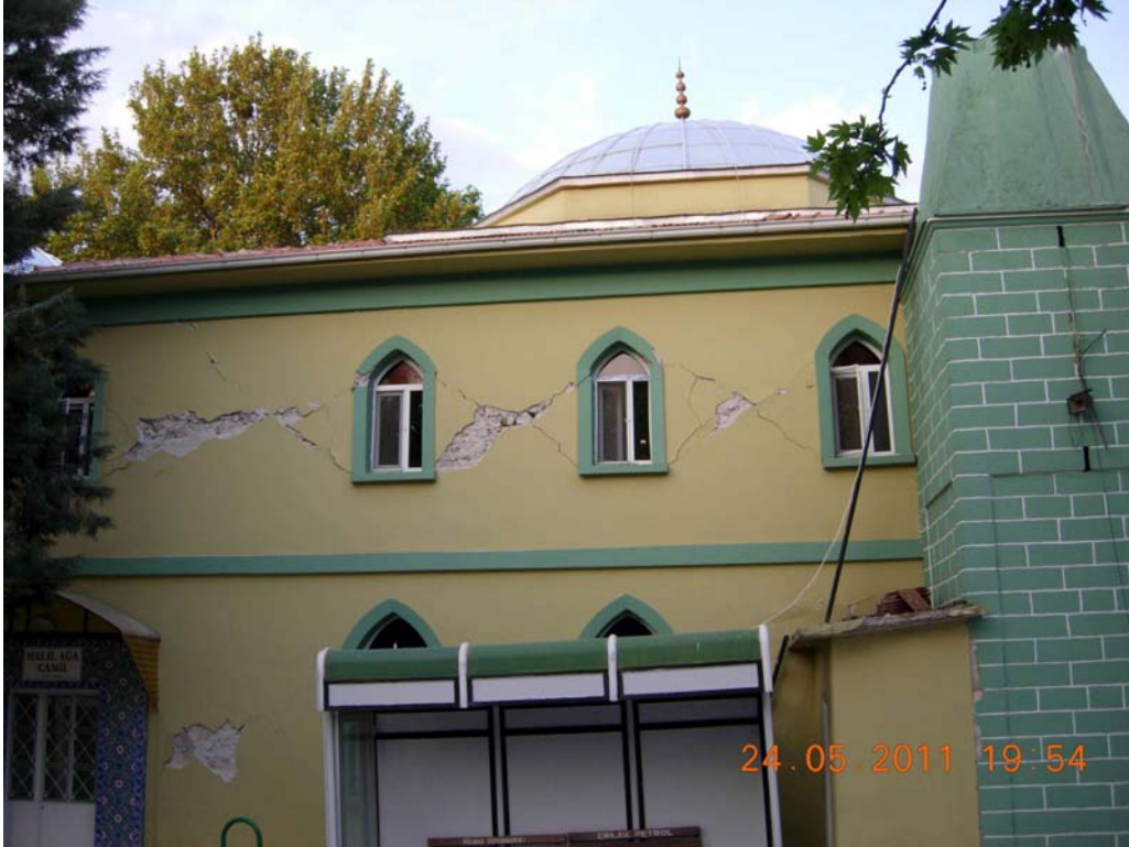
Şekil 82: Yığma cami duvarlarında hasar
