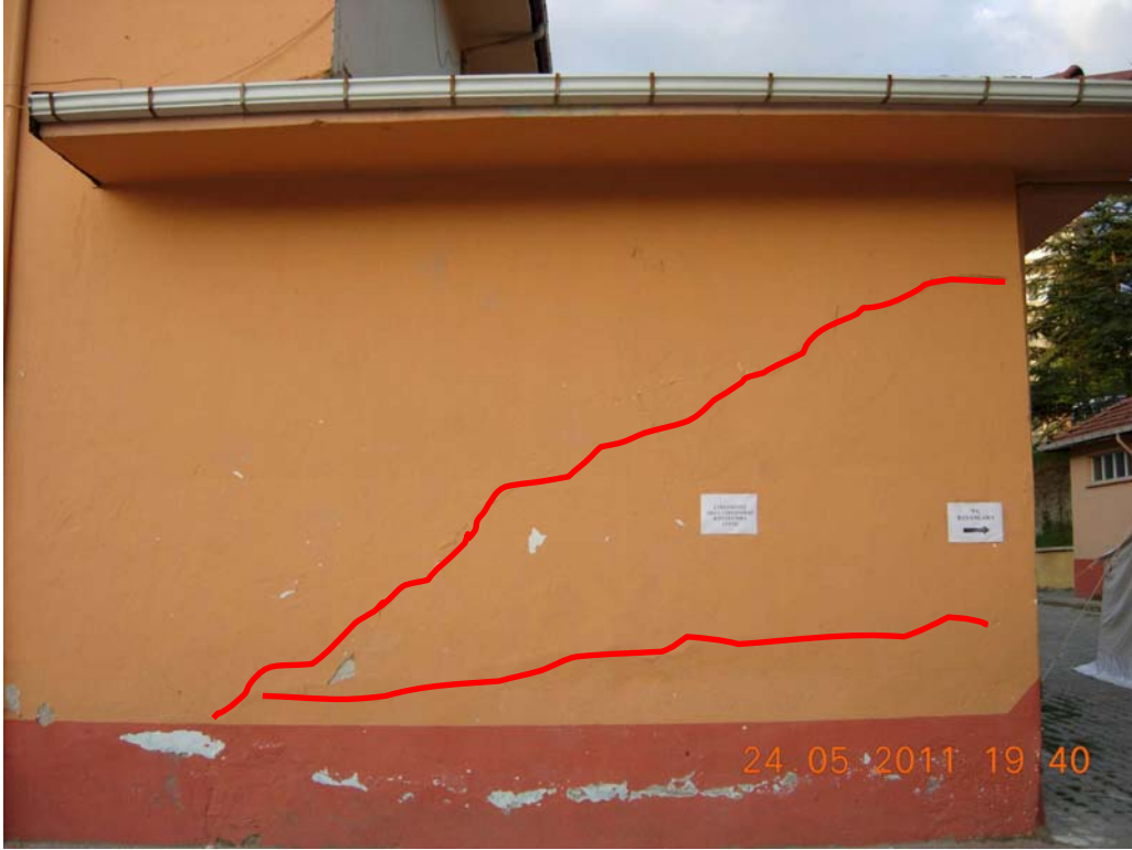
Şekil 76: Okul binasının yağma bölümünde dış duvar çatlakları
