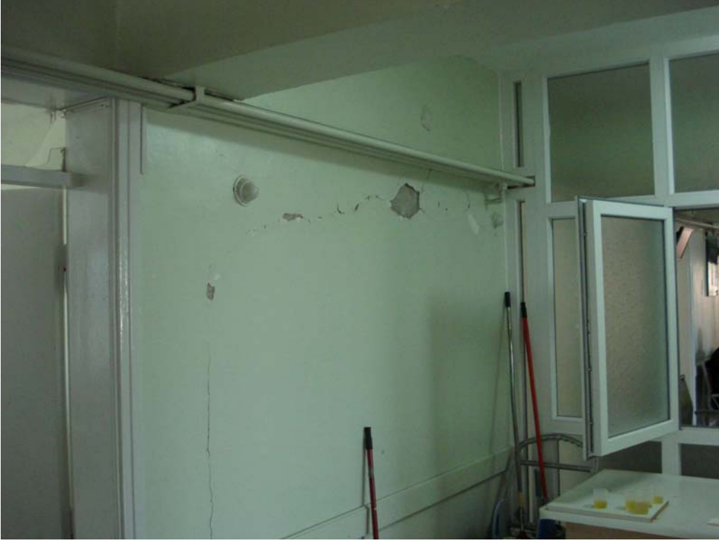
Şekil 71: Hastane kompleksinin 2000' lerin başında inşa edilen binası – dolgu duvarı çatlağı
