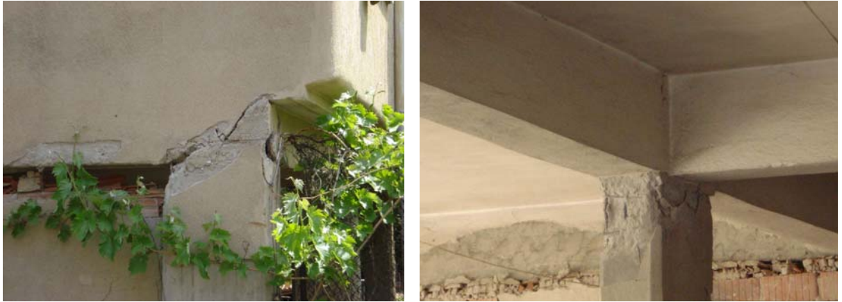
Şekil 54: Kolon uçlarında ağır hasar
