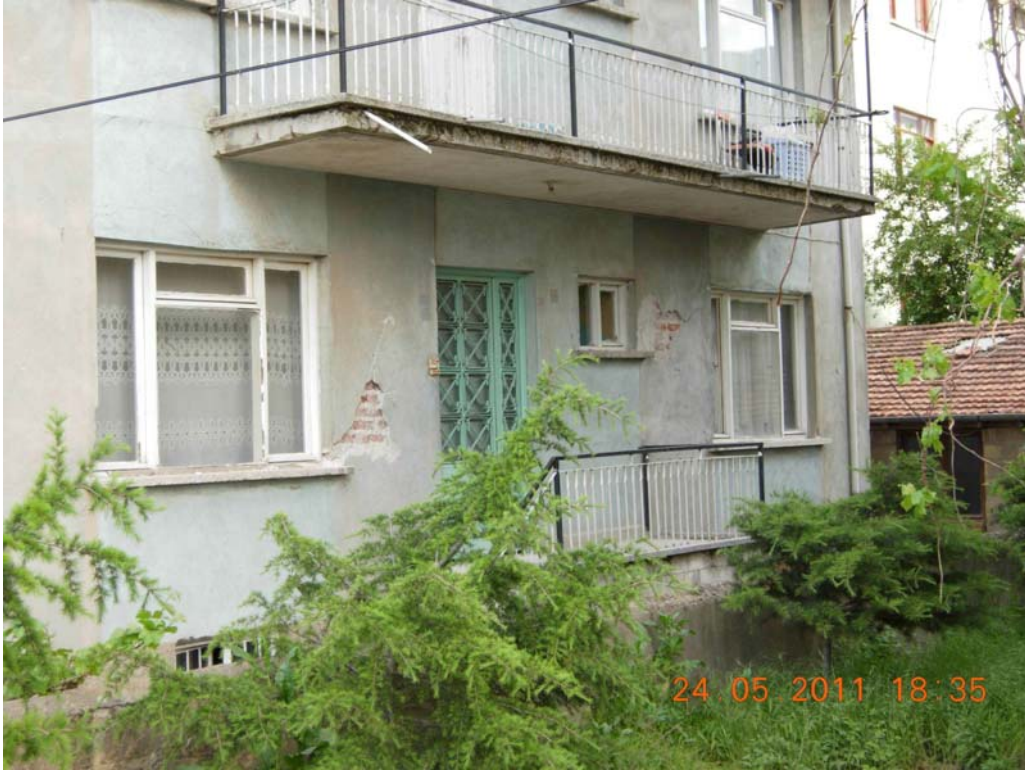
Şekil 83: 3 katlı yığma binanın zemin katında hasar
