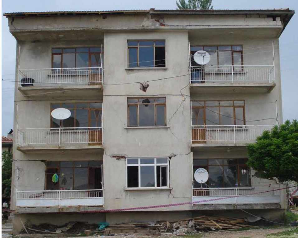
Şekil 80: Gökçeler Köyü, 3. seviye hasarlı bina- ön görünüm
