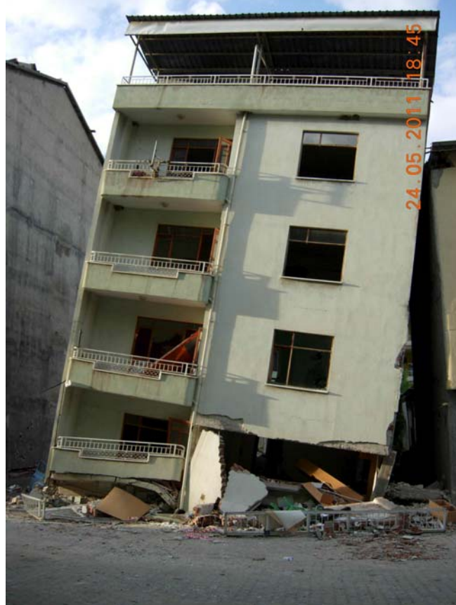
Şekil 47: İlçe merkezindeki yıkılan bina
