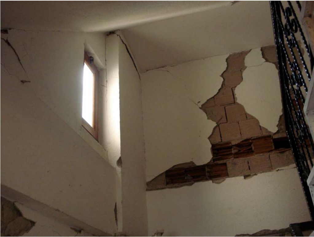
Şekil 72: Hastane kompleksinin karşısındaki bina – merdiven kovanındaki dolgu duvarı çatlağı
