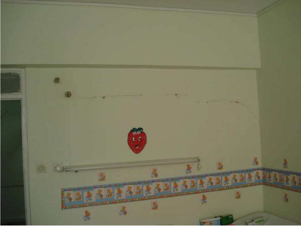
Şekil 69: Hastane kompleksinin 2000' lerin başında inşa edilen binası – dolgu duvarı çatlağı
