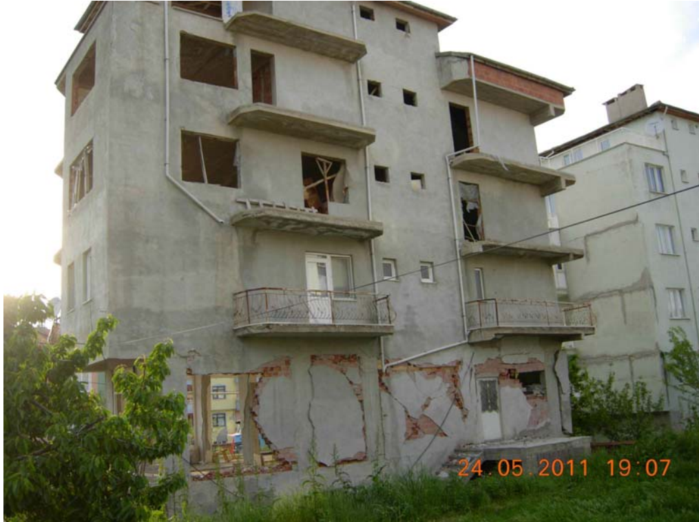
Şekil 58: İnşaa halindeki binada yapısal olmayan, dolgu duvar hasarları
