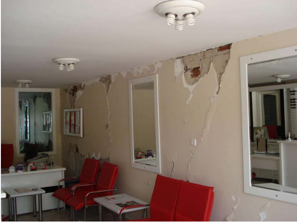
Şekil 73: Hastane kompleksinin karşısındaki bina – zemin kat dolgu duvarı çatlağı (optik ve eczane olarak kullanılıyor)
