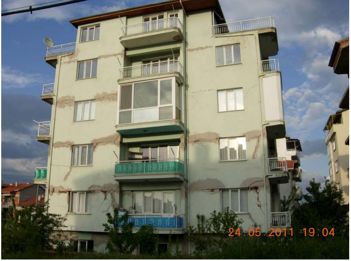
Şekil 57: Daha önceki depremlerde hasar gördüğü, bu hasarların sıva ile kapatıldığı, ancak aynı yerlerde tekrar çatlaklar oluştuğu anlaşılan bina
