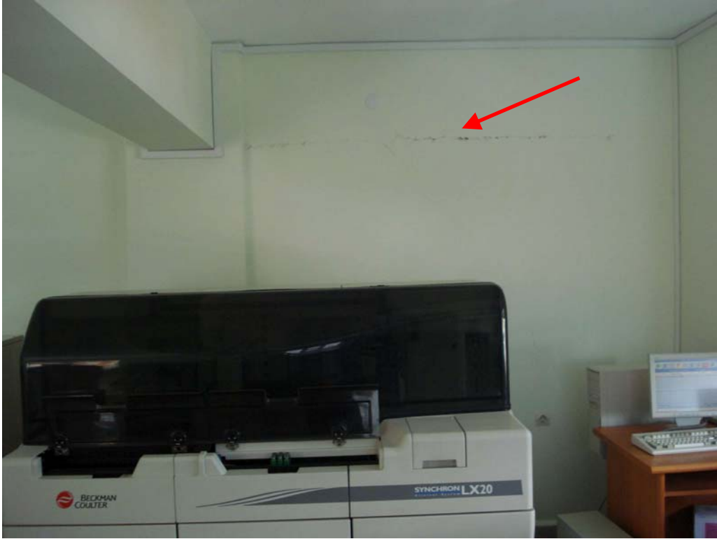
Şekil 68: Hastane kompleksinin 2000' lerin başında inşa edilen binası, biyokimya laboratuvarı (yukarıdaki fotoğraf ile aynı oda) – dolgu duvarı çatlağı, cihazın yer değiştirdiği gözlenmiştir
