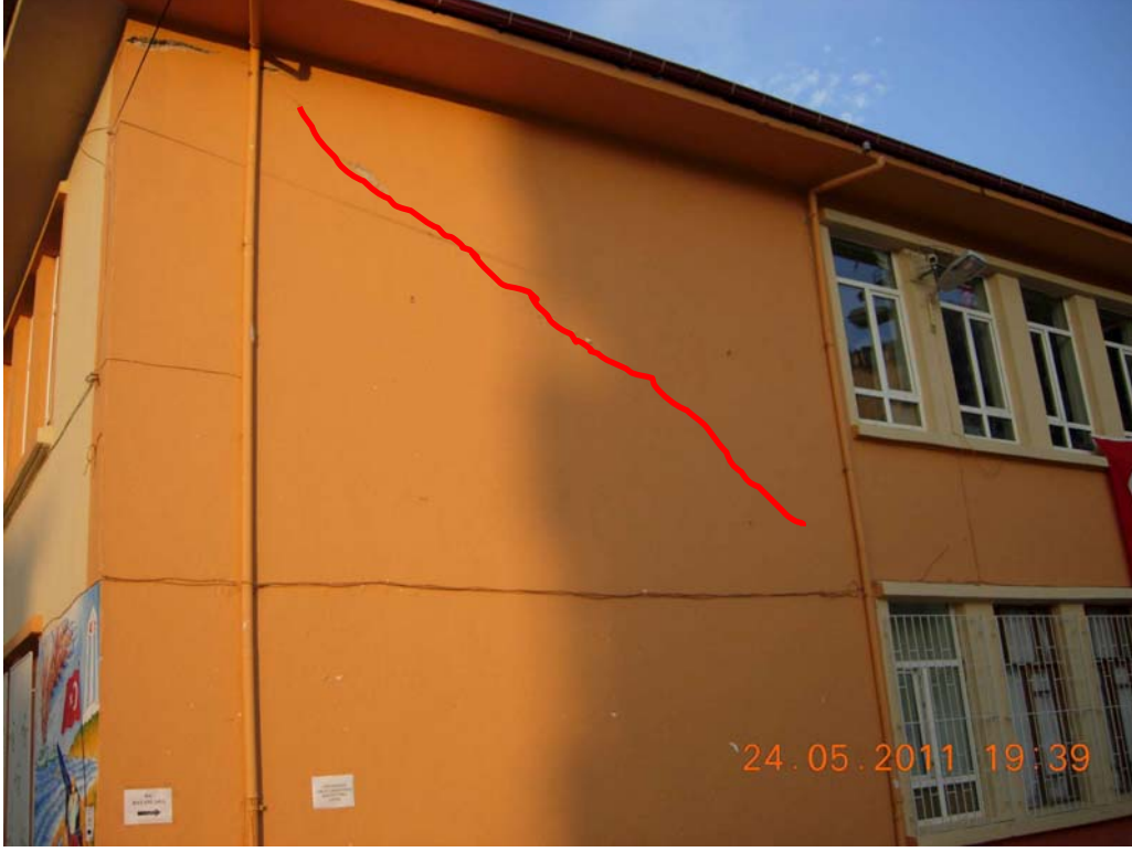
Şekil 77: Okul binasının yığma bölümünde 2. katta dış duvar çatlakları
