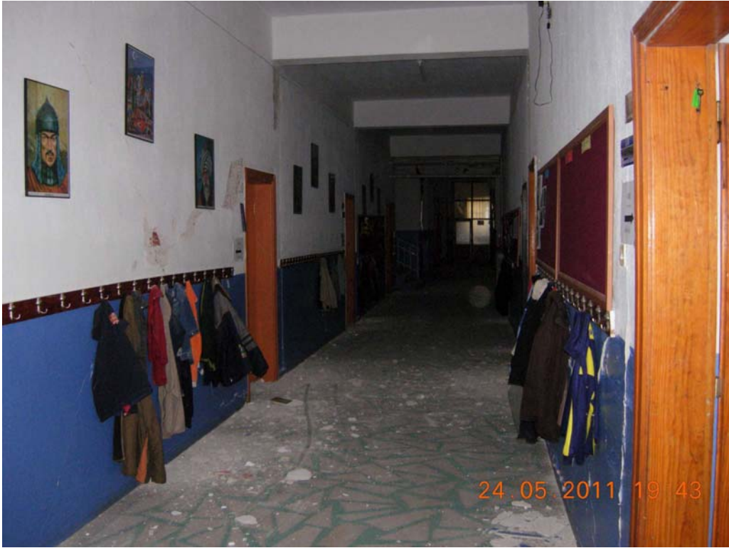
Şekil 78: Okul binasının yığma bölümünün içi - sıva dökülmeleri
