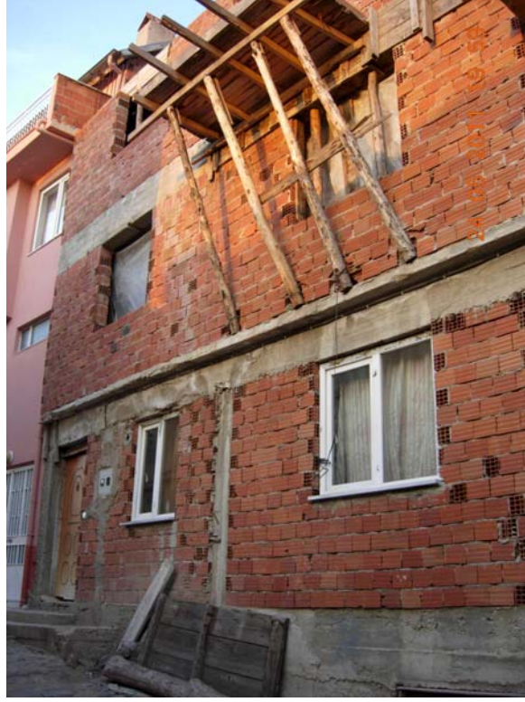
Şekil 45: Boşluklu, dolgu duvarı tuğlasının betonarme kirişlerle birlikte taşıyıcı olarak kullanıldığı, 3. katı yapım aşamasında olan bina örneği!!!
