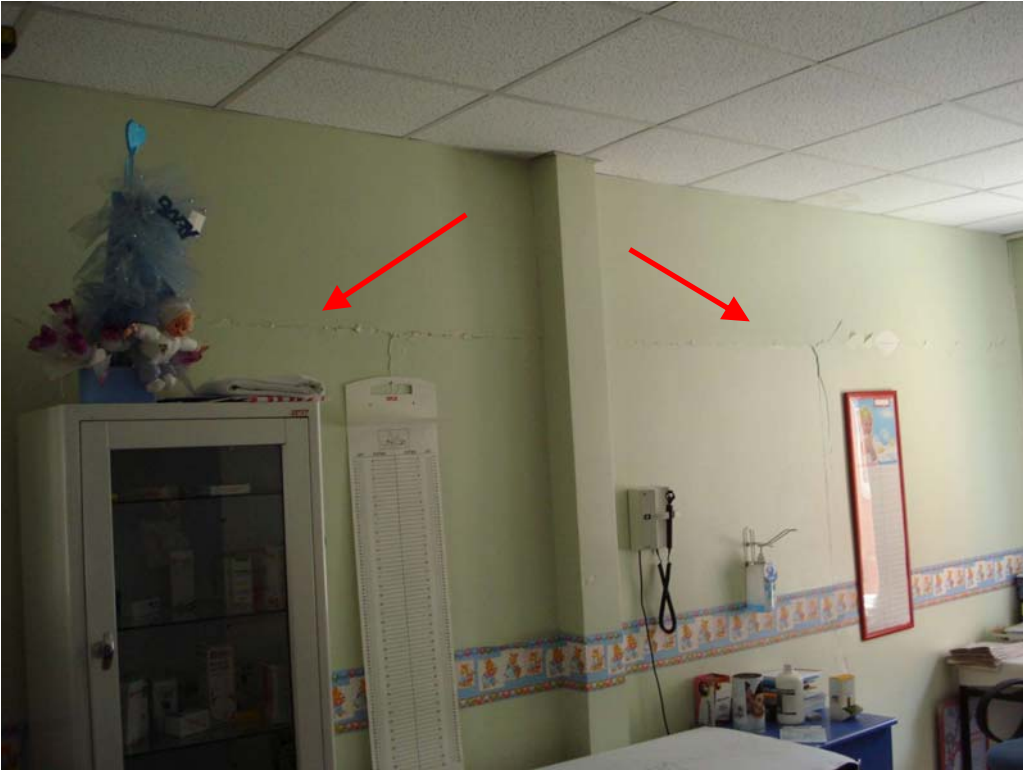
Şekil 70: Hastane kompleksinin 2000' lerin başında inşa edilen binası – dolgu duvarı çatlağı
