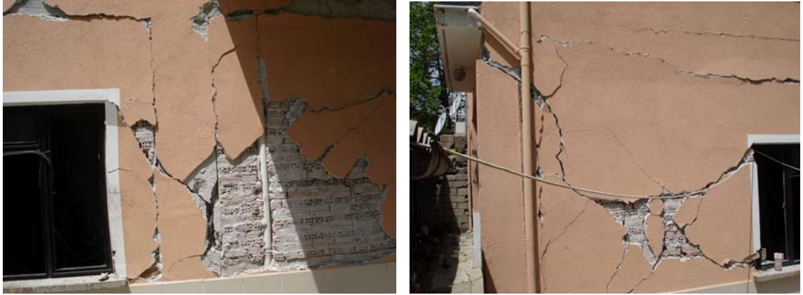
Şekil 53: Bir önceki resimdeki ile aynı bina, benzer hasarlar
