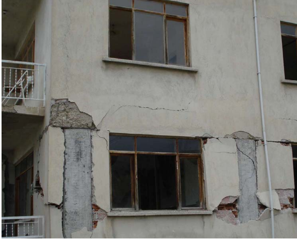
Şekil 81: Gökçeler Köyü, 3. seviye hasarlı bina- yan görünüm
