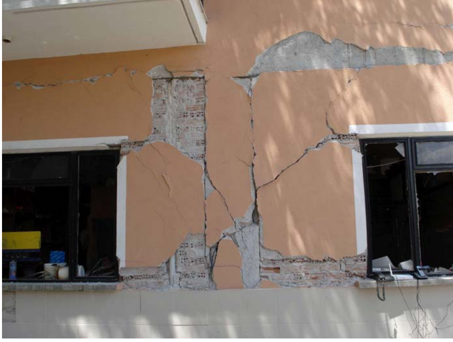
Şekil 52: Az sayıdaki ağır yapısal hasar örneklerinden biri, kolon kısa kolon gibi çalışmış, dolgu duvarı olarak standart boşlukla tuğla değil delikli tuğla kullanılmış
