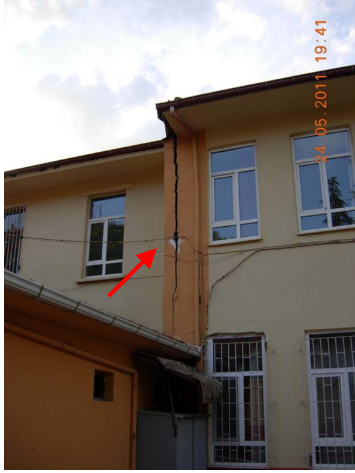
Şekil 79: Okul binasının yığma bölümü ile betonarme bölümü arasında oluşan çatlak
