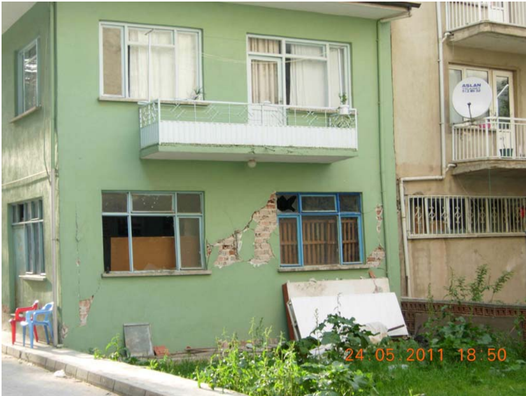
Şekil 84: 2 katlı yığma binanın zemin katında hasar
