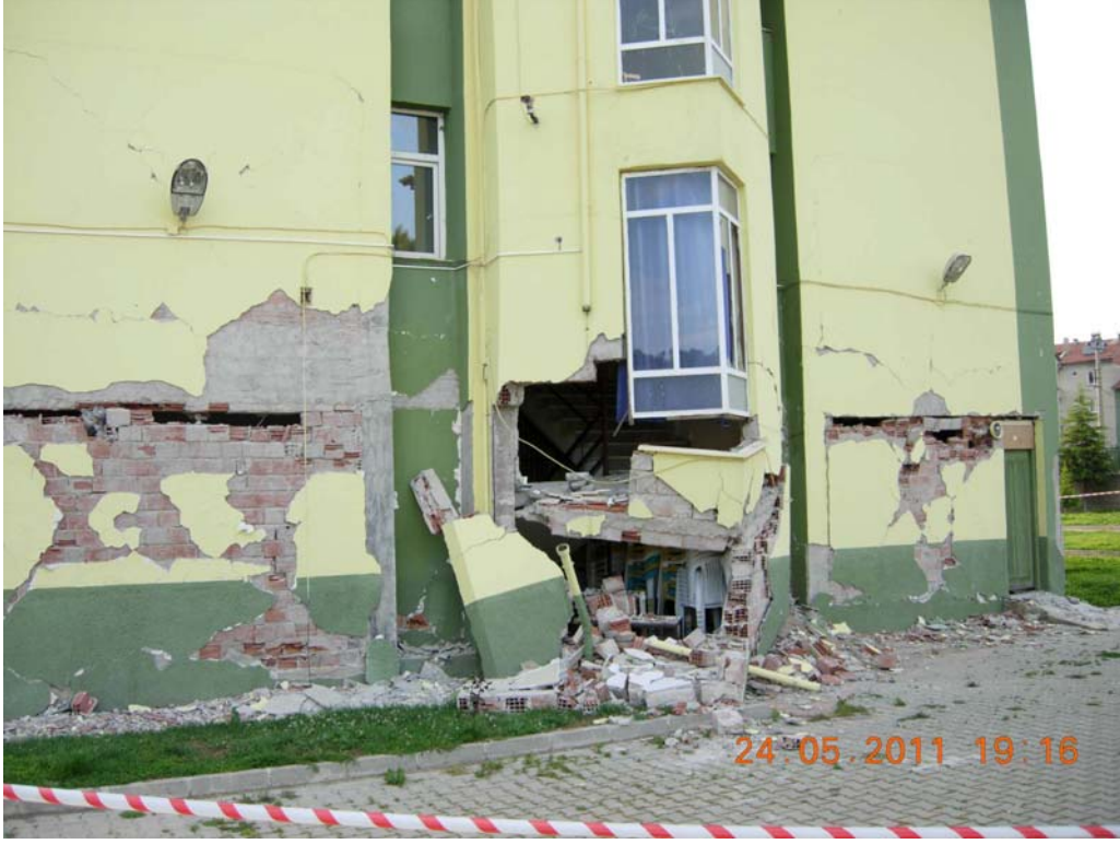
Şekil 75: Okul binasının betonarme bölümünde, merdiven kovası hasarı, bölgedeki genel alışkanlık merdiven döşemelerinin oldukça ince ve kirişsiz yapılmasıdır
