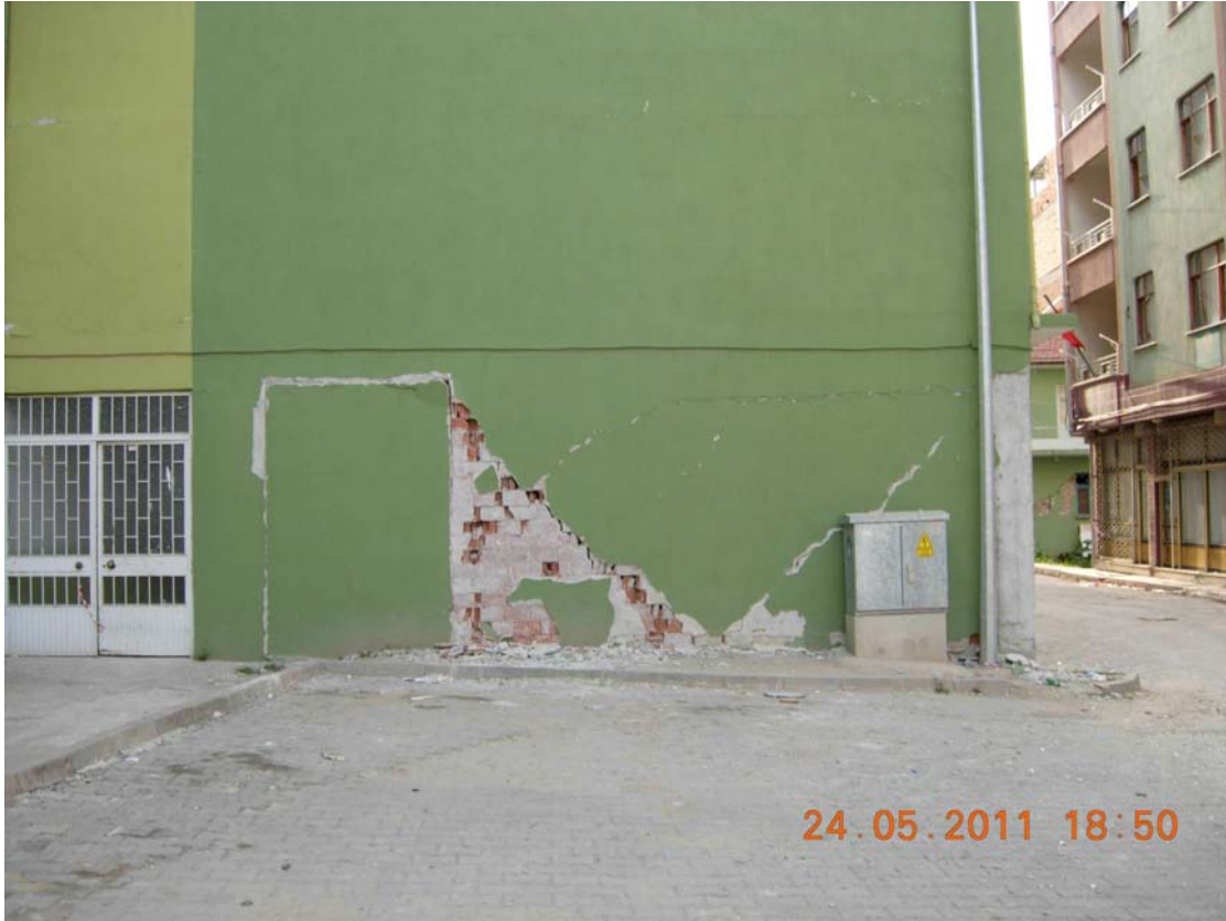
Şekil 56: Yıkılan binanın karşısındaki bina-cephedeki dolgu duvarı çatlağı
